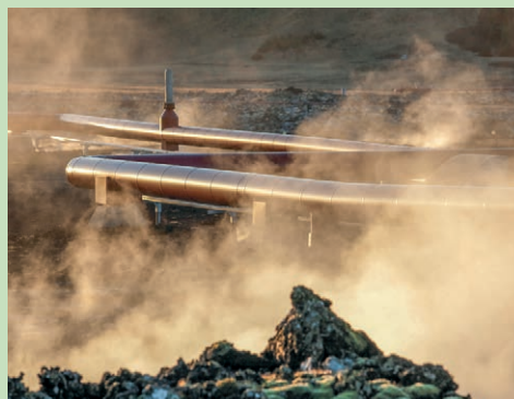
3.1.15-rasm. Geotermal elektrostansiya quvuri
